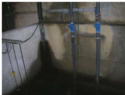
verzamelbekken op niveau -2 van de parking
